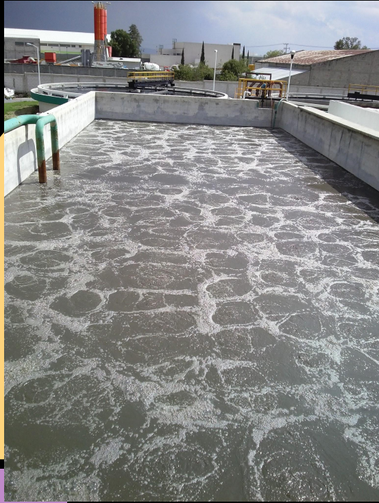
Digestor de de lodos, aquí aparece el metano
